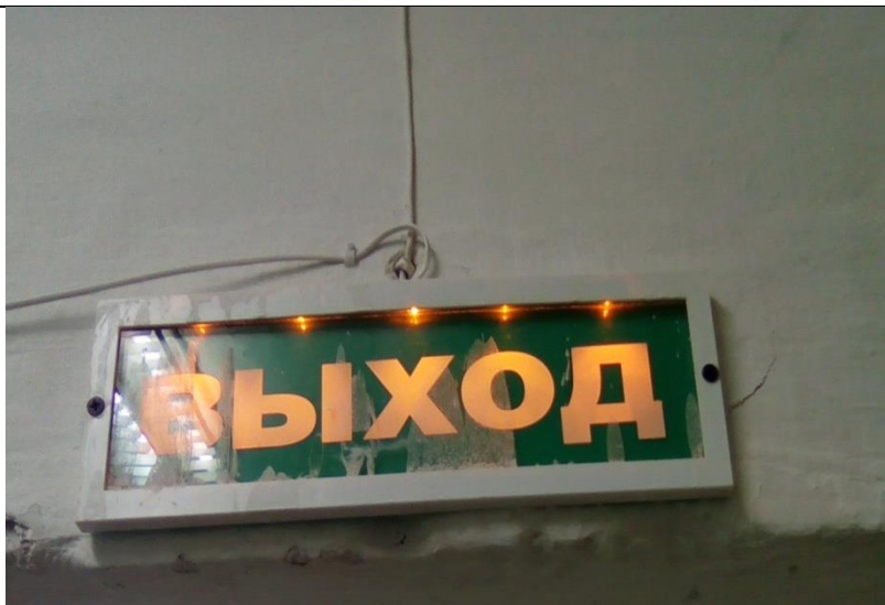
№ 39, Визуальные средства путей эвакуации
